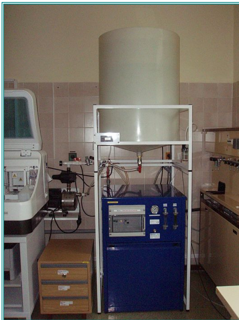
reversní osmóza, nová investice na OKB-H, je přístroj, který odstraňuje z vody pyroxeny a bakterie a vyrábí demineralizovanou vodu bez použití agresivních chemikálií
