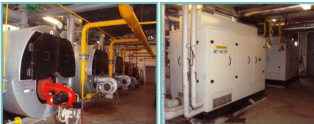
prostor kotelny, kde jsou umístěné parní kotle a 2 kogenerační jednotky od fi Tedom (v roce 2012 bude podána žádost na SFŽP na rekonstrukci kotelny)
