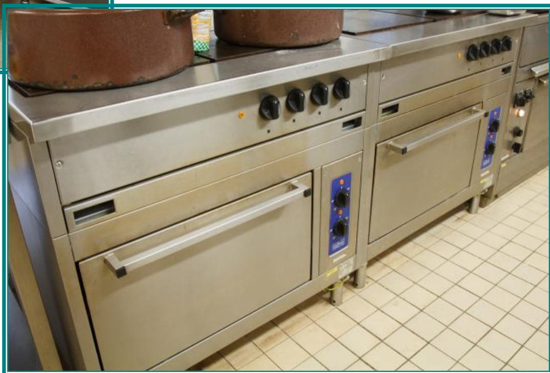
Provoz kuchyně zaznamenal v roce 2015 rekonstrukci výdejny jídla (foto nahoře), byla zakoupena nová vyhřívaná finesa pro rozvoz jídel zaměstnancům do jídelny a také dva nové elektrické sporáky v hodnotě 150 tis. Kč.
